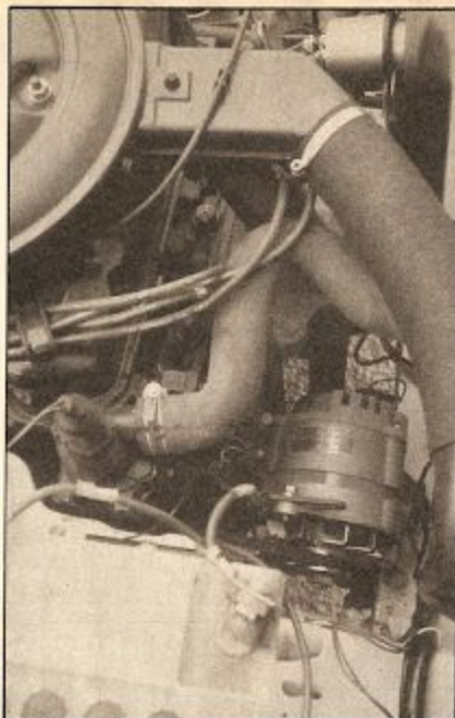
La cantidad de tubos, cables y manguitos es notable.
